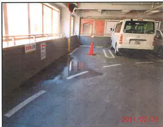
補修前は雨が強く降るとフロアに雨水が溜まった(2月18日写す)
